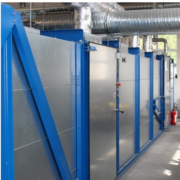
Bild 2: Tauchanlage mit Zu- und Abluftverrohrung
